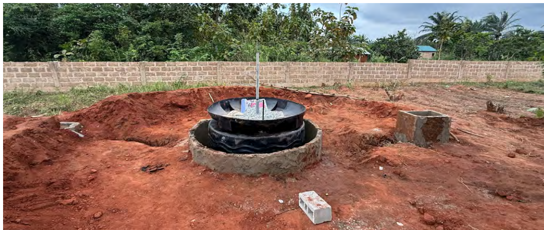
Figure 30 - Biodigesteur installé à plus de 15 mètres de la cuisine, sans ombrage autour, avec espace pour la mise en place des cuves de chargement et de décharge
