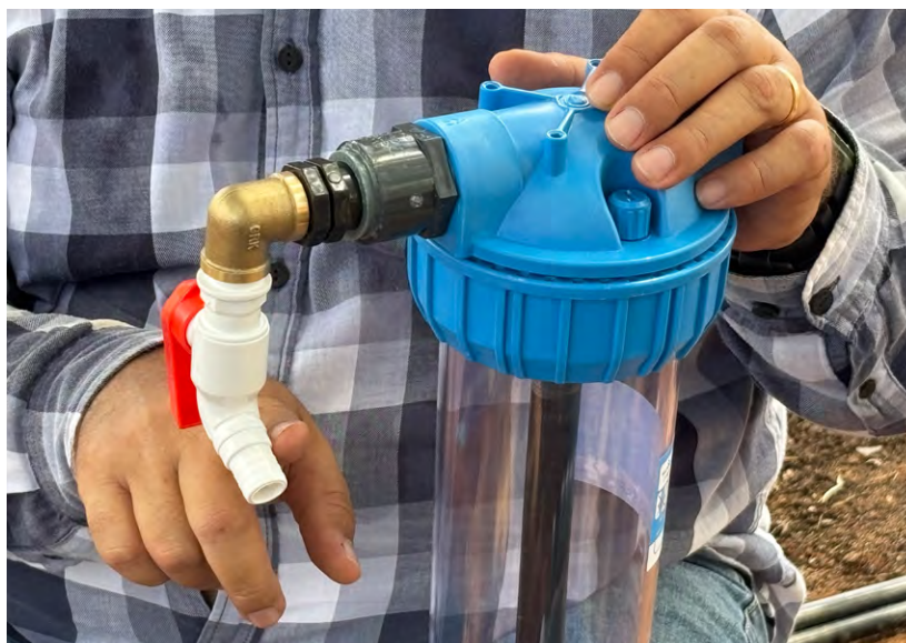
Figure 52 - Filtre coupe-flamme avec vanne de sécurité, où sera installé le flexible de sortie du biogaz
